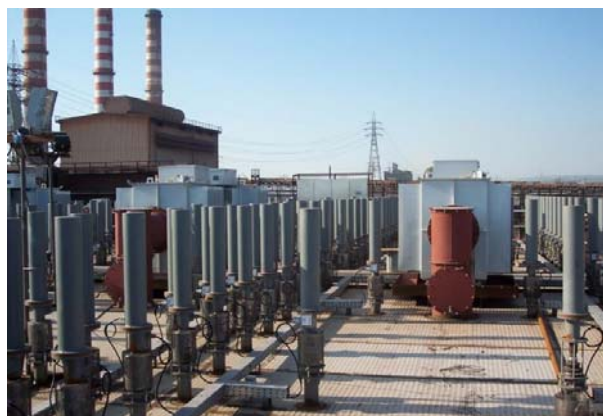
Рис. 3 Электромагнитные молотки установленные на крыше электрофильтра.
