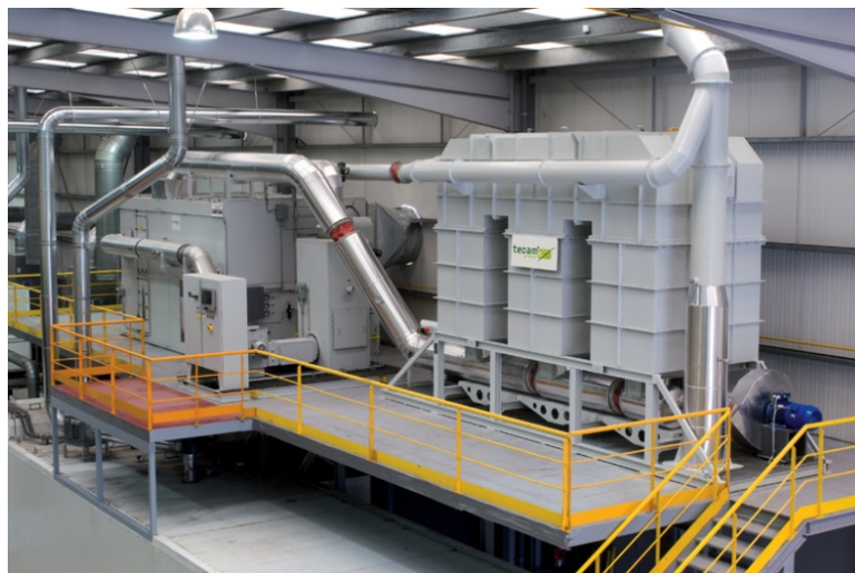
Фото: Цеолит Ротор Концентратор + РТО- установлен в компании "Несеуго", Испания, для обработки 40 000 м 3 /ч ЛОС
