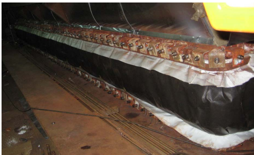
Рис. 1. Компенсатор конвективной шахты котла
