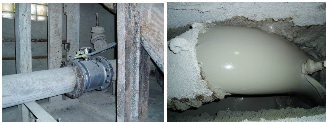
Рис.2 Измерение расхода шламов в печи обжига с применением электромагнитного расходомера OPTIFLUX 2300 DN400.
