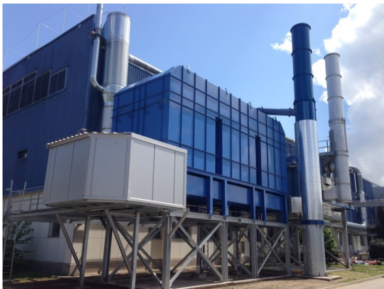
Фотография: Регенеративный Термический Окислитель установленный на фармацевтическом заводе в Словении объем воздуха 55,000 м3/час.
