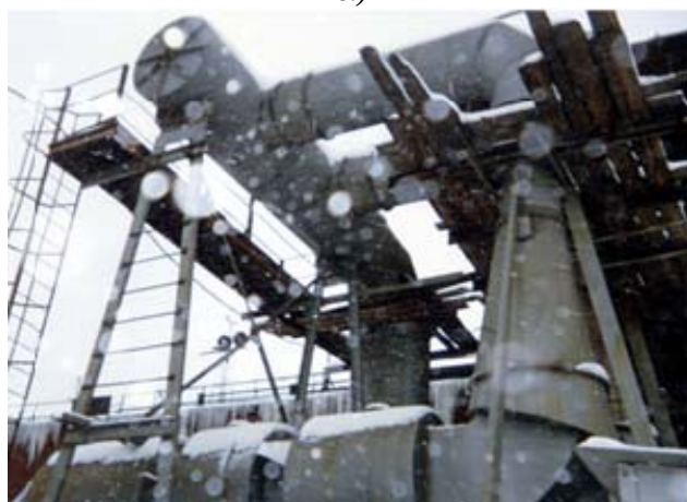
Рис. 6. ГОУ мартеновской печи АО «Ижора-сталь» г. Санкт-Петербург, Колпино
