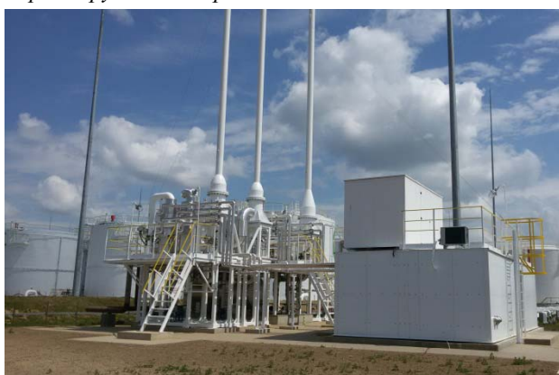
Рис.24. ККР 1200 ТУ 3614-001-53976876-2009, номинальная производительность 1200 м 3 /час. Фаниполь, РБ. Одновременная и независимая рекуперация паров автомобильных бензинов при больших и малых дыханиях резервуарного парка и при работе АСН в автоцистерны.
