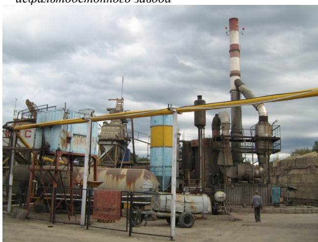
Рис. 4. ГОУ для очистки газов из сушильного барабана асфальтобетонного завода (г. Адлер, в работе с 1990 г.)
