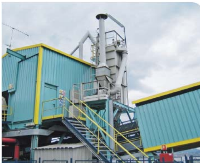
Рис. 3. Обеспыливание пункта перевалки между лентой
