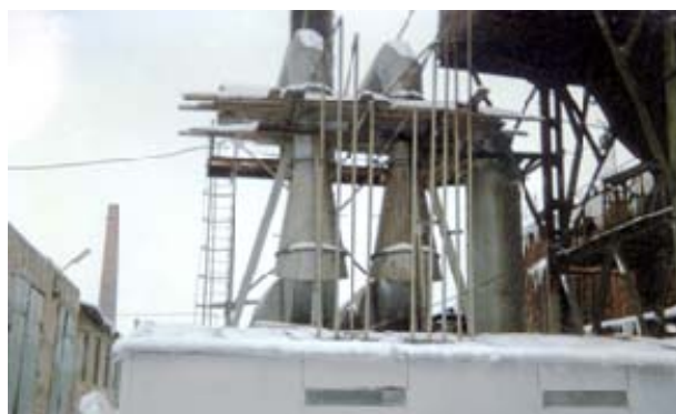
Рис. 7. ГОУ мартеновской печи АО «Ижора-сталь» г. Санкт-Петербург, Колпино
