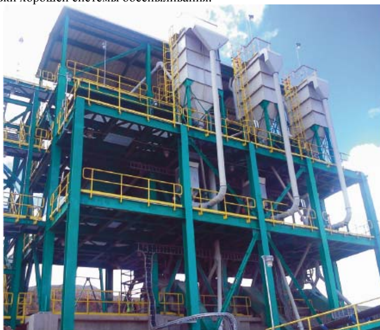
Рис. 5. Обеспыливание элеваторов и ленточных конвейеров
