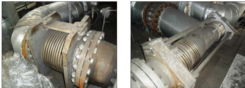
Разгруженный сильфонный компенсатор с отводом DN 300; 1,6 МПа и сдвиговый сильфонный компенсатор DN 250; 1,6 МПа в обвязке насосов на ТЭЦ.
