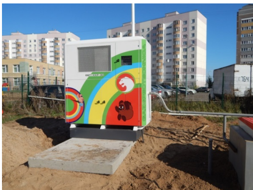
Рис.25. ККР 30М ТУ 3614-001-53976876-2014, номинальная производительность 30 м 3 /час. Казань, АЗС группы компаний «Транзит Сити». Рекуперация паров автомобильных бензинов при больших дыханиях резервуарного парка АЗС.
