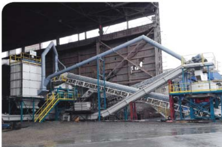
Рис. 2. Обеспыливание дробилки и ленточного конвейера
