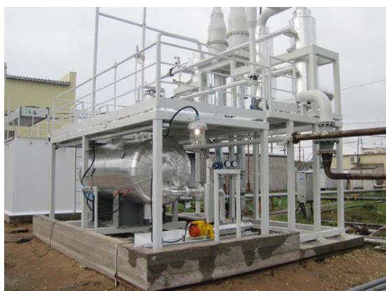
Рис.23. ККР 300 ТУ 3614-001-53976876-2009, номинальная производительность 300 м 3 /час. Гатчина, компания ЗАО «ЛВЖ-701». Одновременная и независимая рекуперация паров прямогонного бензина при больших и малых дыханиях резервуарного парка и при работе АСН в автоцистерны.
